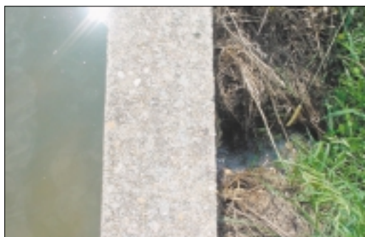
Fotografía N° 36. Pérdidas en acequia.
