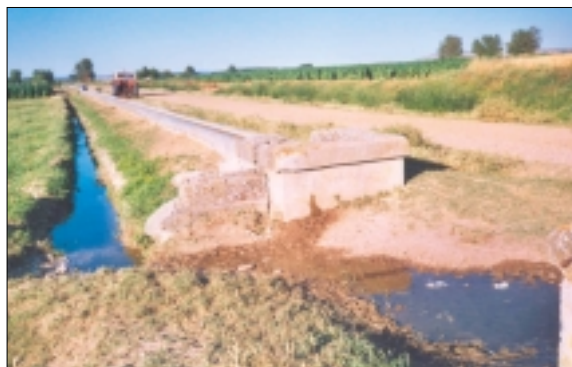
Fotografía N° 32. Pérdidas en sifón en acequia A.31.2.
