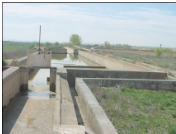
Fotografía N° 11. Entrada del laberinto de decantación.
