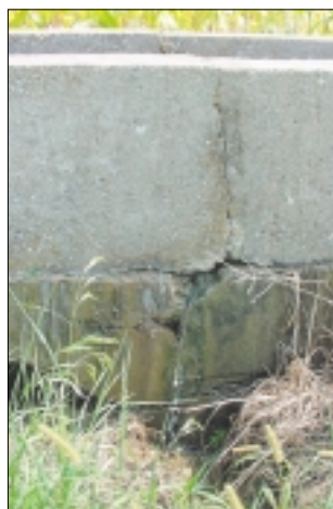
Fotografía N° 35. Pérdidas en acequia
