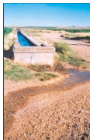
Fotografía N° 31. Pérdidas en sifón en acequia A.31.
