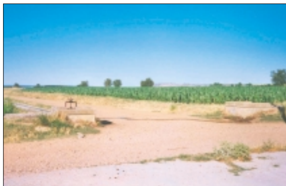
Fotografía N° 33. Pérdidas en sifón. Acequia A.31.
